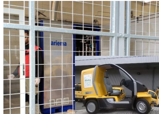
Electrolizador La Poste (Francia), 2015
