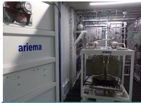
Electrolizador containerizado. Proyecto Aurora (Sacyr), 2017
