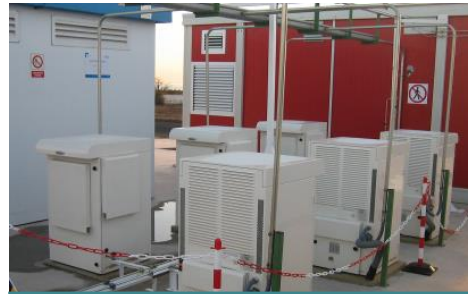
ITC-Canarias. 30 kW 6 pilas de combustible, 2007
